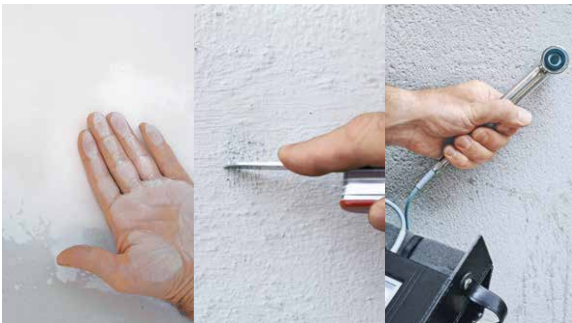
Bild links: Prüfung auf mehrende Flächen
