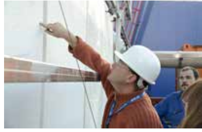
Bei der optischen Beurteilung nach Prüfung durch den sachverständigen Prüfer muss das WDV-System schadensfrei, also ohne Risse sein.
