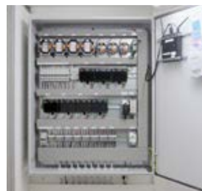
KKS-Schaltschrank mit Camur II Komponenten
