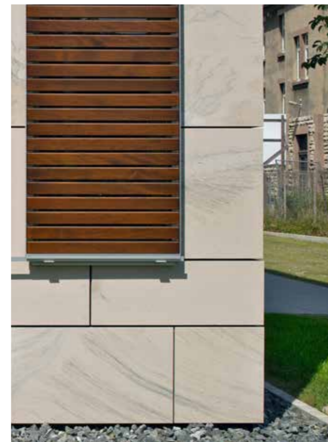
Hjørnekonstruktion med naturstensfacader med synlige fuger. Hus i den botaniske have i Braunschweig, Tyskland.
